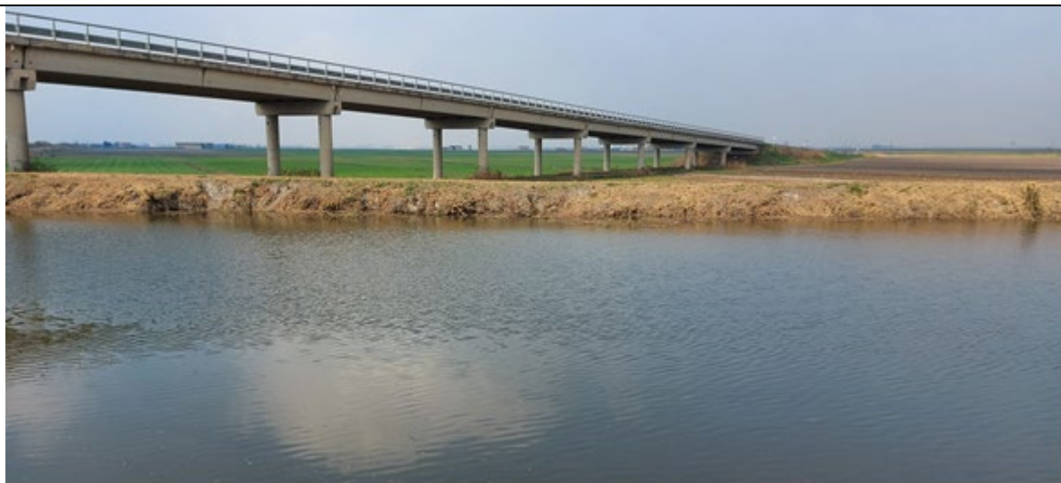
Foto n.3: Foto dissesto idrogeologico – Canale dei Cuori
