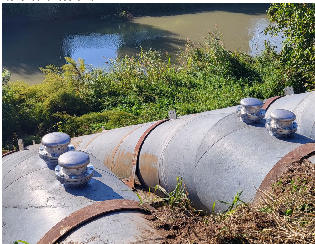
Nuove valvole di sfiato meccaniche posizionate sulle condotte di scarico idrovora Beolo
