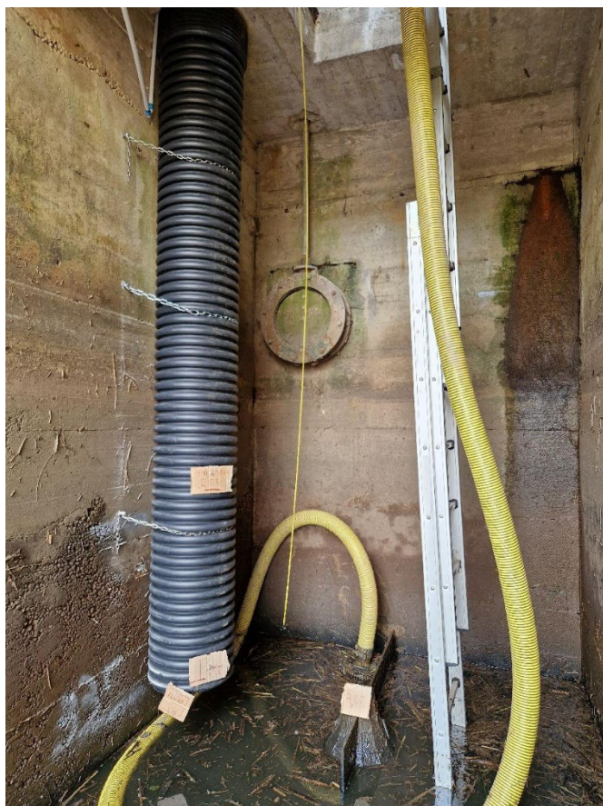
Idrovora Palù Massara - installazione sistema di arresto a minimo livello con doppia sicurezza.
