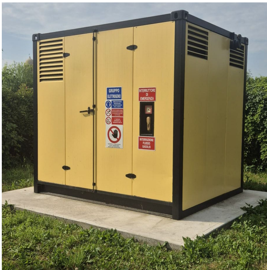
Nuovo gruppo elettrogeno installato presso la sede Consorziale di Este
