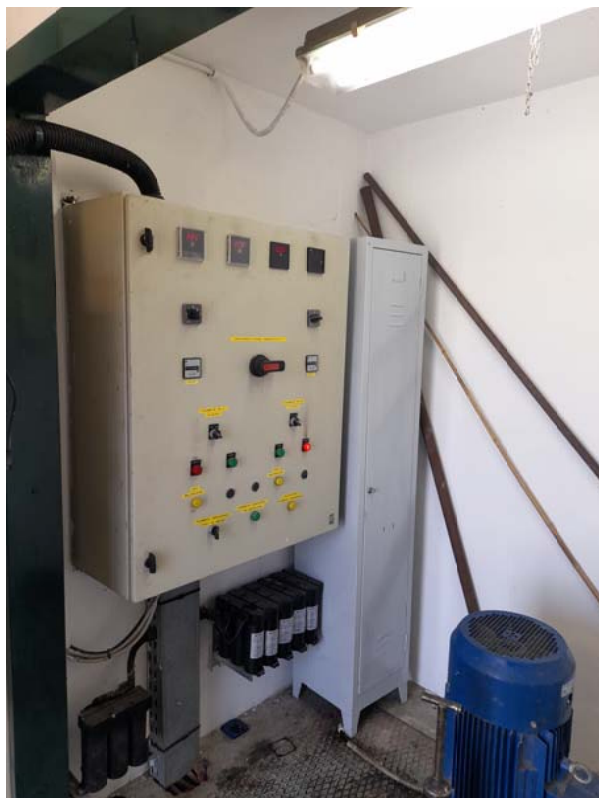
Quadro elettrico BT dell'impianto idrovoro Baone prima dell'intervento
