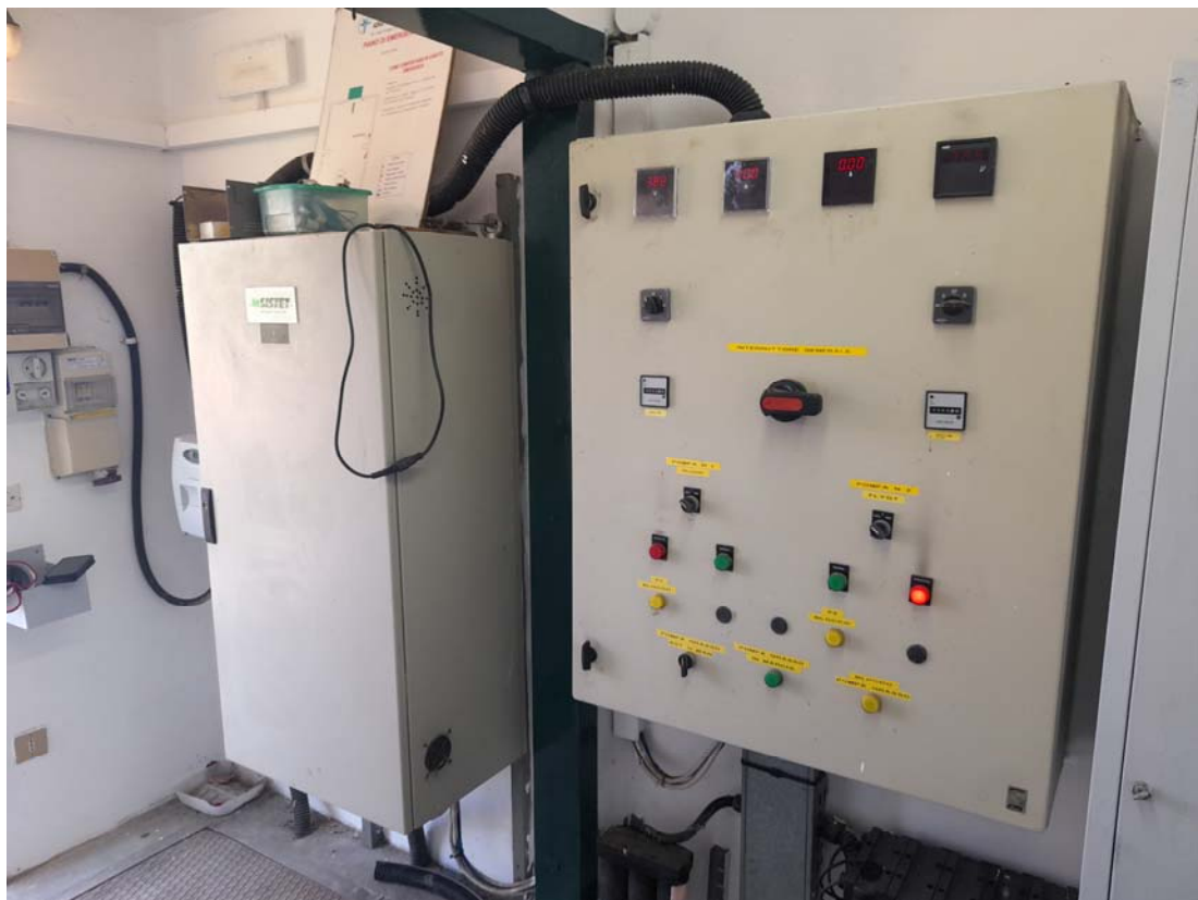
Quadro elettrico BT e TLC dell'impianto idrovoro Baone prima dell'intervento
