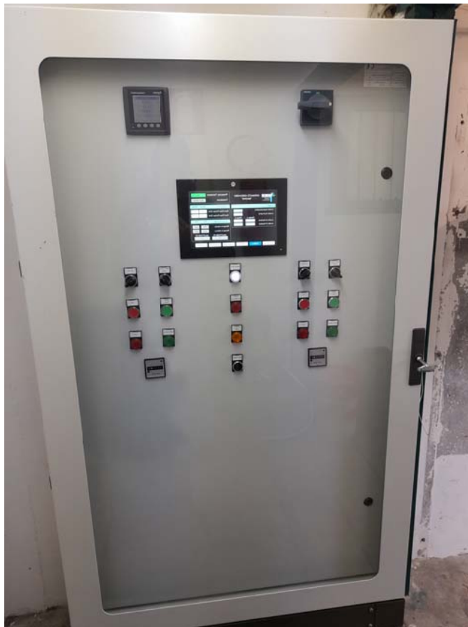
Quadro elettrico BT dell'impianto idrovoro Baone dopo l'intervento
