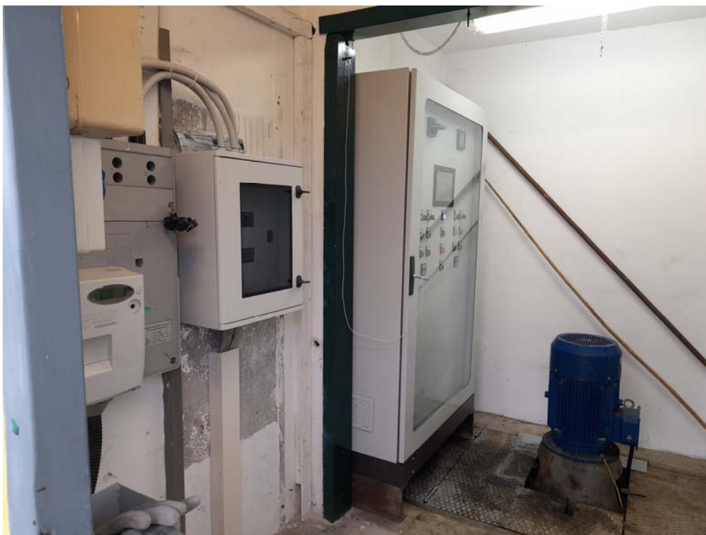
Quadro elettrico BT e PLC dell'impianto idrovoro Baone dopo l'intervento
