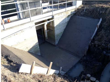
Scolo Cons. Conselve – manufatto di rincollo e rilancio "Conselve 1". Realizzazione rivestimento di fondo e sponde in c.a.
