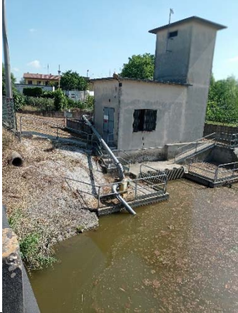
Sostegno Ponte Zata in Comune di Tribano. Posa di una pompa mobile per favorire l'alimentazione dello scolo Olmo durante la criticità idrica dovuta alla siccità.
